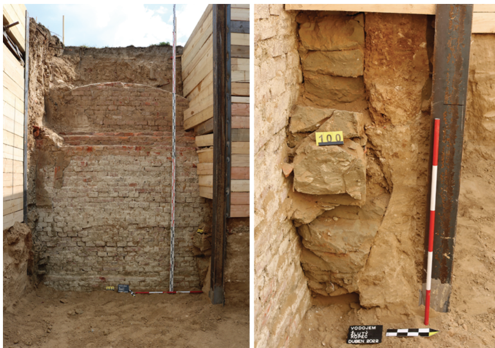
Obr. 26. Brno, ulice Tvrdého. Sonda S1 s odkrytými historickými konstrukcemi vodojemu z roku 1894. Zajílování pomocí jílových lisovaných kostek s. j. 100. Foto Archaia Brno z. ú.
