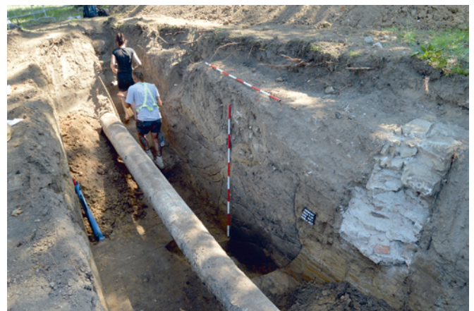
Obr. 40. Kroměříž, Kojetínská ulice. Pohled na dokumentované souvrství ve výkopu pro napojení plynovodního potrubí. Foto M. Paulus.
