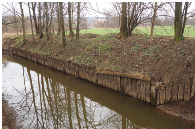
Obr. 1. Dolní Lhota. Štětová stěna vystavěná na zpevnění břehu po protržení hráze v roce 1938. Foto M. Novák.
