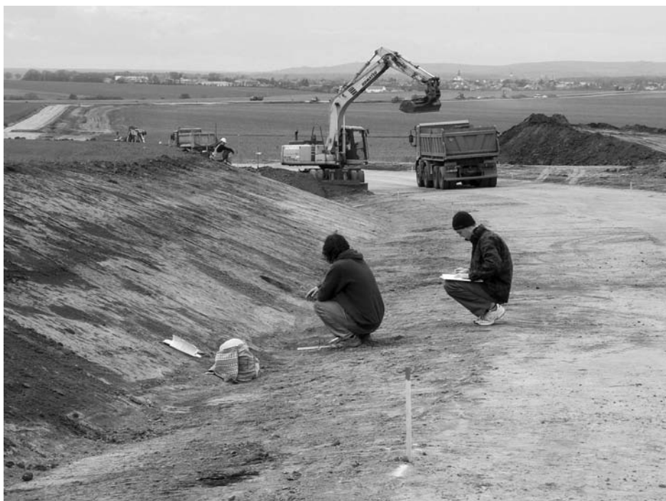
Obr. 78. Silnice II/495 Uherský Ostroh – Hluk, říjen 2014. Pohled od jihovýchodu na jižní svah silnice s novověkými objekty (jámy pro stromky).
